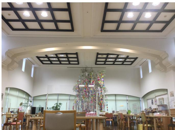
しもつけ荘 食堂スペース天井のLEDライト
